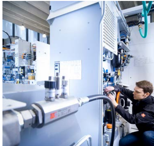
Bild links: Messdatenabgleich verbauter Sensorik der technischen Gebäude- ausrüstung
